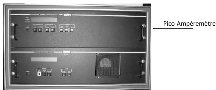
Figure 2.3 – Panneaux de mesure du courant
