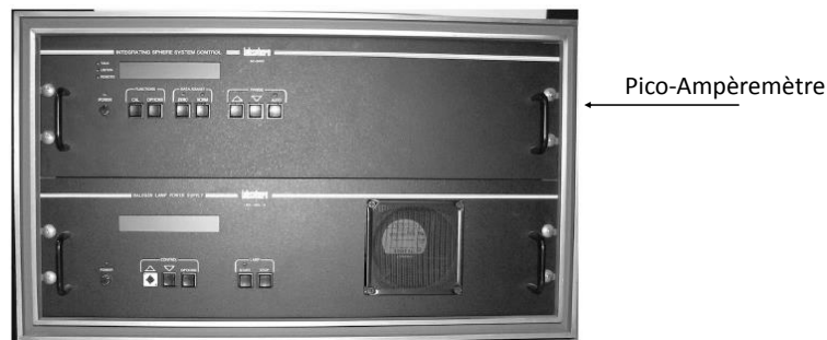
FIGURE 2.3 – Panneaux de mesure du courant
